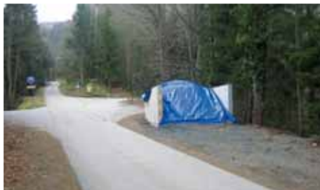
Neue Splittbox (1 von 4), Abzweigung Primus vlg. Hochkorp
